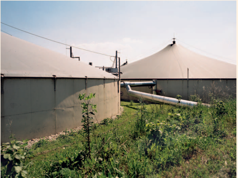
Abb. 5: Durchflussbiogasanlage mit Folienhaube als integrierter Gasspeicher
