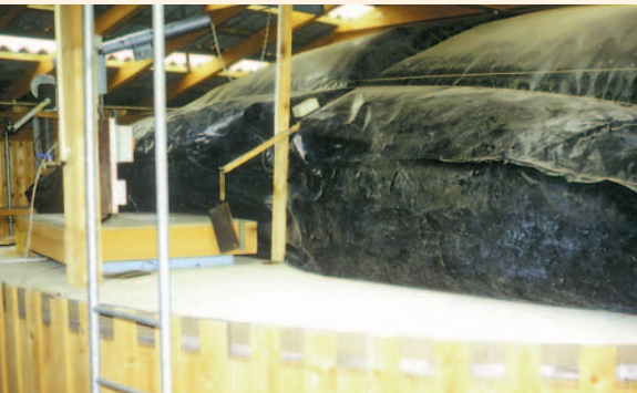
Abb. 6: Biogasfolienspeicher im belüfteten Dachraum über dem Faulbehälter
